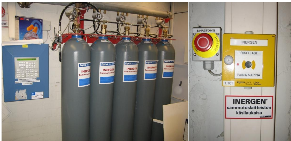
Kuvat 11 ja 12: Automaattisia sammutuslaitteistoja suositellaan maanalaisien tilojen kriittisimpiin paikkoihin ja ajoneuvoihin (Lähde: TTL:n Mainari-projekti).
